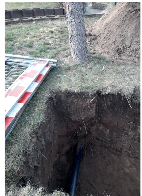
So geht es nicht: Eine mit einem Baum überpflanzte Trinkwasserleitung.
